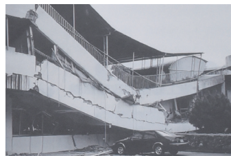
圖 2-72：九二一大地震工藝所技術組木工、染織、絹工廠崩塌現場，《臺灣工藝》，No.1
